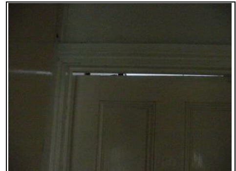
Gap above door
